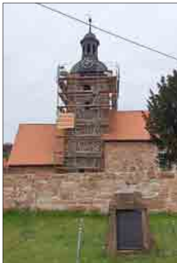
Zur Zeit mit Gerüst: Kirchturm in Heilingen Foto: Heiko Hoffmann, Firma Bennert
